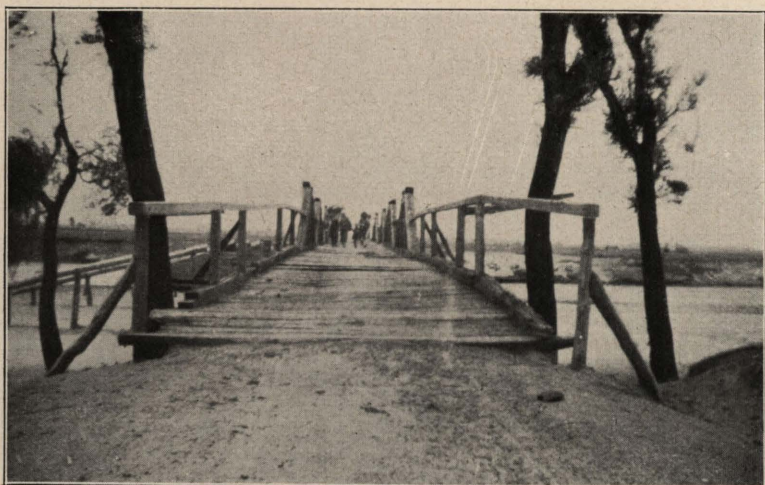
160. Alte Holzbrücke über die Prosna bei Bonteshagen (Chocz), Kr. Kalisch BB 7169. Baufällig, nur für den örtlichen Verkehr mit Pferdefuhrwerken, nicht für Kfz. geeignet.
